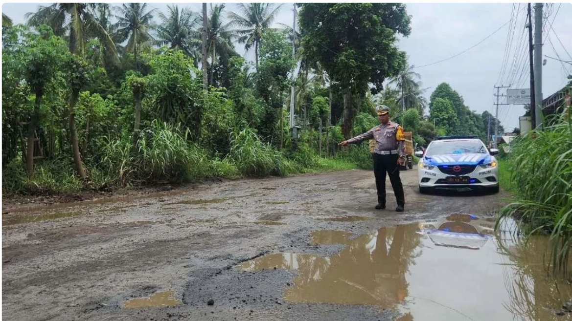
(Kondisi jalur lingkar Ketapang rusak parah, menjadi atensi Satlantas Polresta Banyuwangi karena jalan ini akan dijadikan obyek rekayasa lalu lintas untuk mengurai kemacetan di Ketapang)
